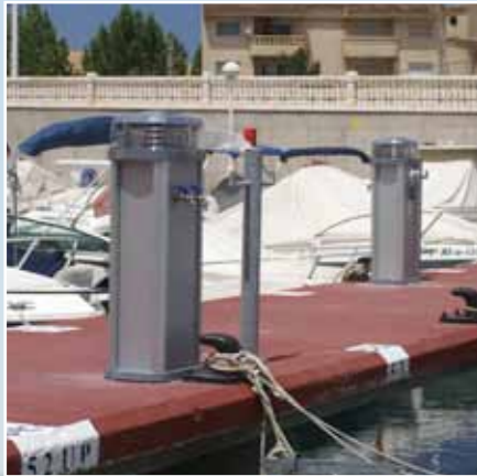
Módulos de Electricidade e Água
